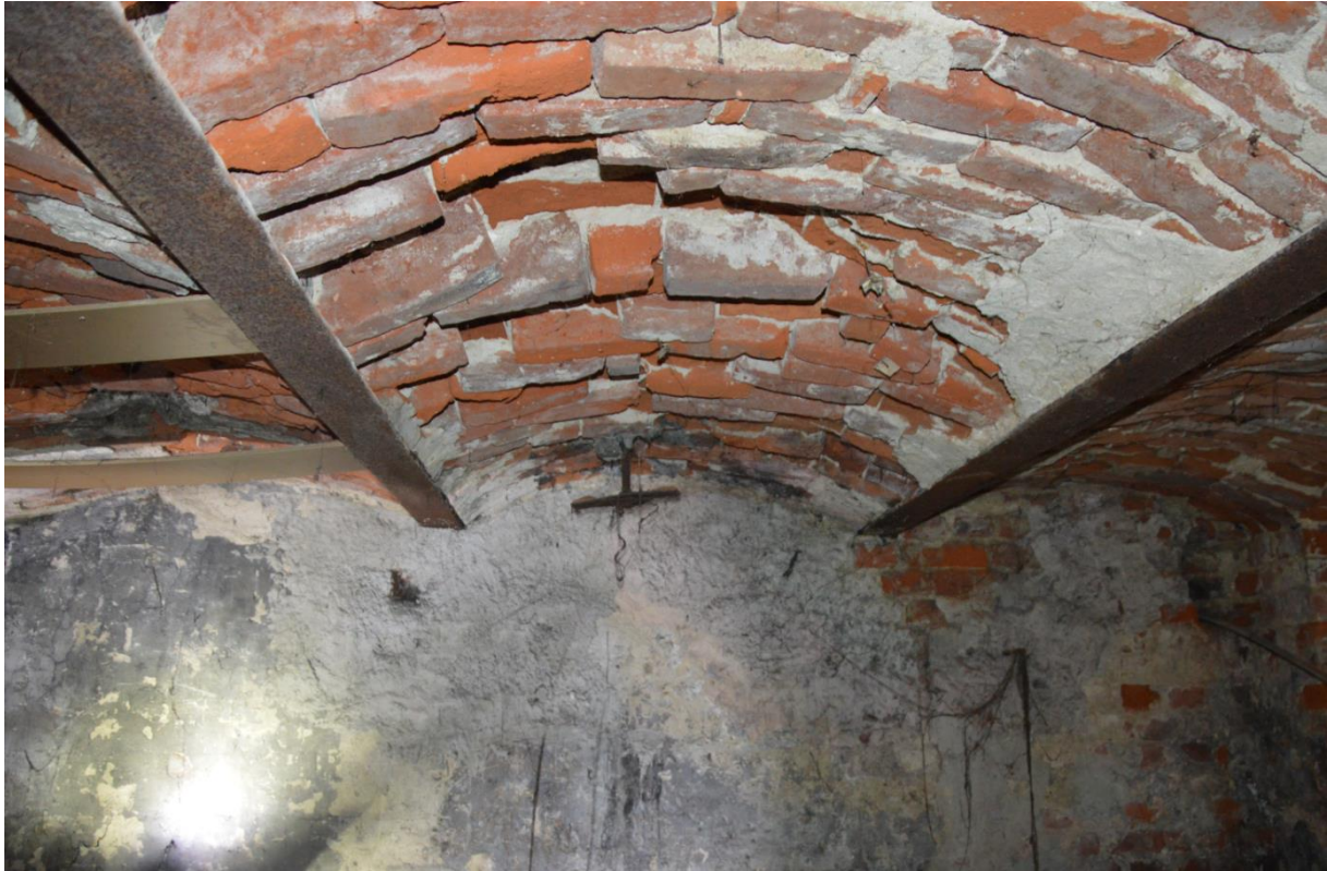
Fot. 3. Ubytki cegieł w sklepieniu ceramicznym, zmurszenie cegieł, brak spoinowania, korozja belek stalowych [1.3]
