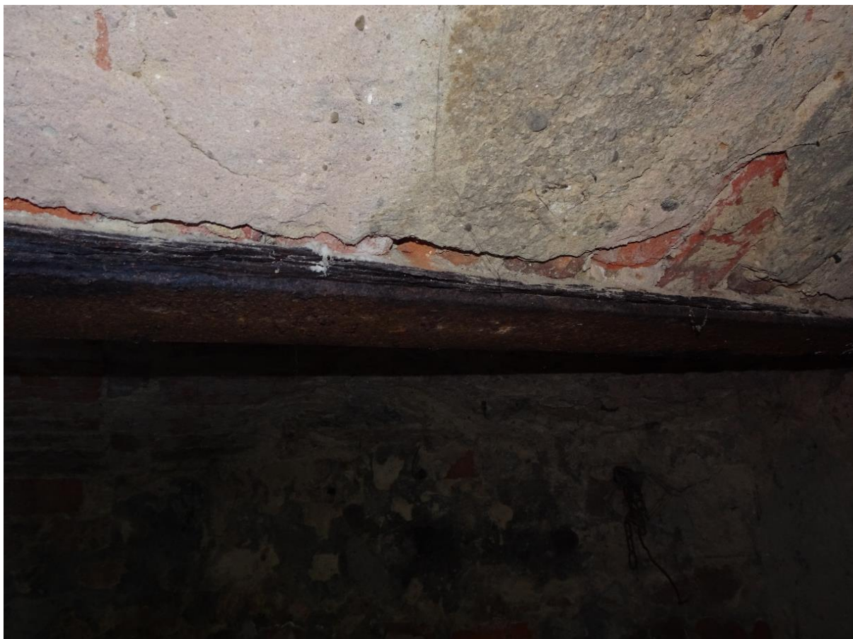
Fot. 5. Silna korozja belki stalowej i rozwarstwieni jej dolnej półki, odspojenia tynku [1.3]
