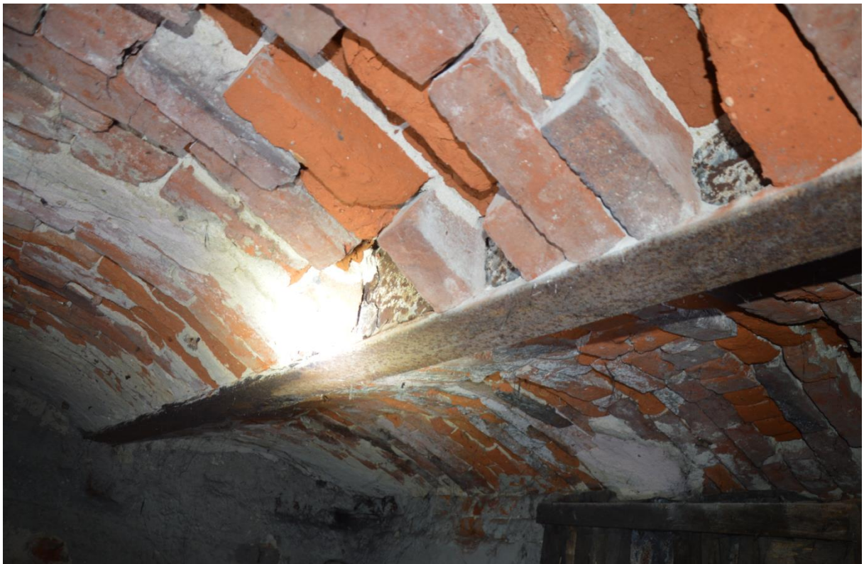
Fot. 4. Ubytki cegieł w strefie podparcia sklepienia, brak spoinowania, korozja belki stalowej [1.3]
