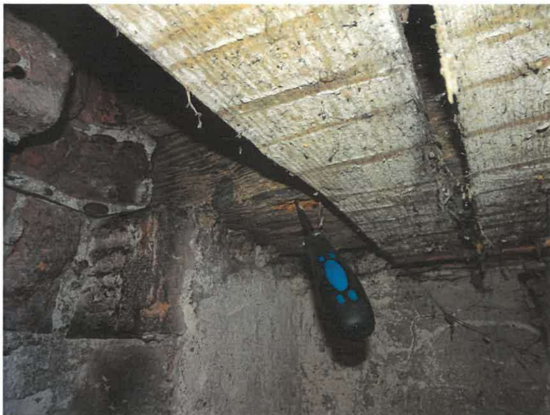
Rys. nr 24. Skorodowany koniec belki stopowej opartej na ścianie wewnętrznej piwnicy budynku frontowego [1.4.].
