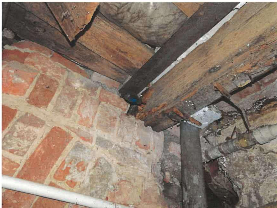
Rys. nr 25. Zbutwiały koniec belki drewnianej oparty na ścianie zewnętrznej od strony podwórka, obok dostawiona belka stalowa [1.4.].
