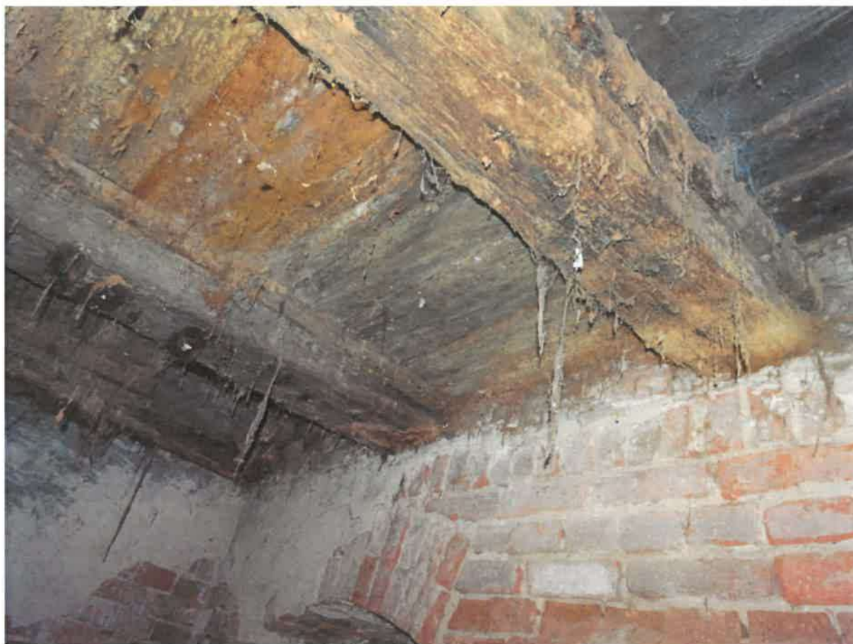
Rys. nr 28. Strop nad piwnicą w budynku oficyny – widoczne zbutwiałe fragmenty belek stropowych oraz deski ślepego pułapu [1.4.].
