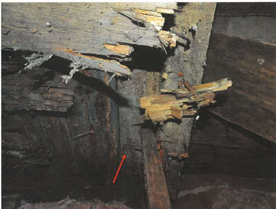
Rys. nr 26. Zbutwiały koniec belki oparty na ścianie zewnętrznej od strony podwórka – widoczna nadbitka wzmacniająca po prawej stronie skorodowanej belki [1.4.].
