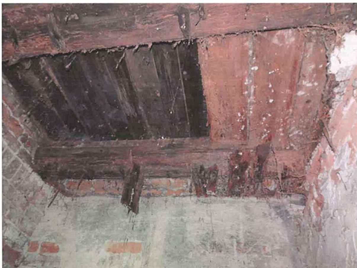
Rys. nr 27. Strop nad piwnicą w budynku oficyny – widoczne zbutwiałe fragmenty belek stropowych oraz deski ślepego pułapu [1.4.].
