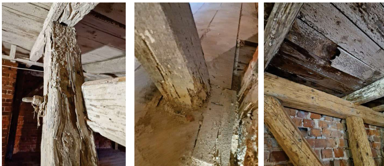
Fot.12, 13, 14 – Widok korozji elementów drewnianych
