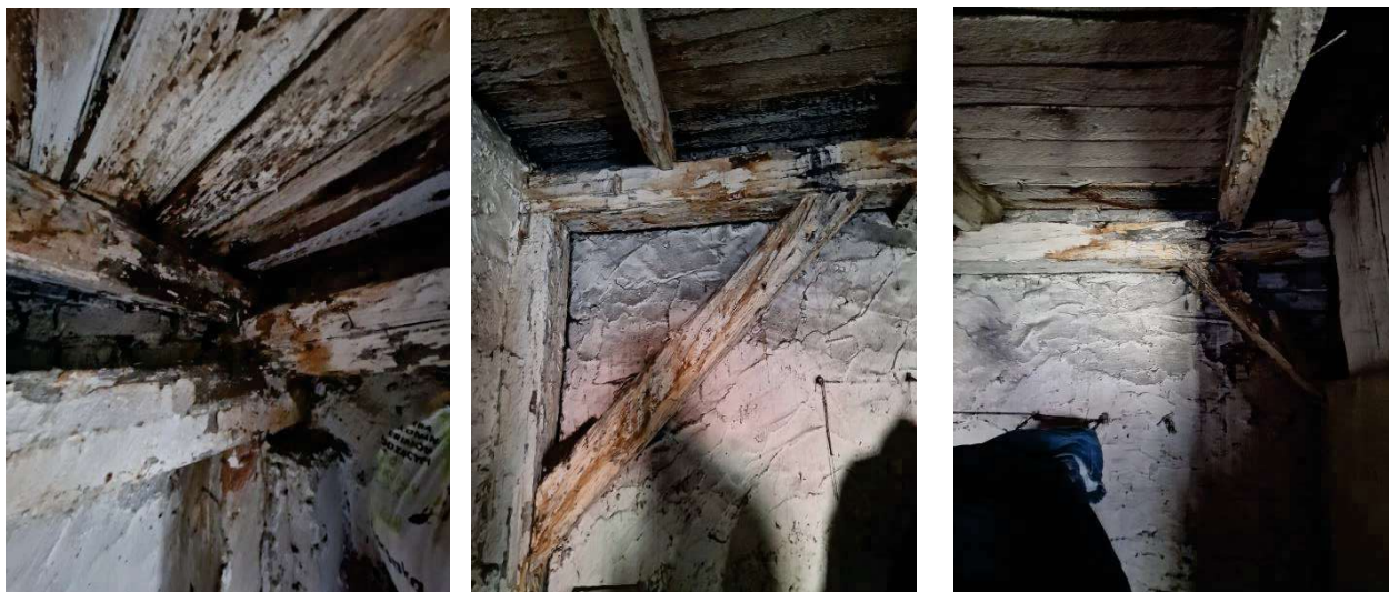
Fot.16, 17, 18 – Widok korozji elementów drewnianych
