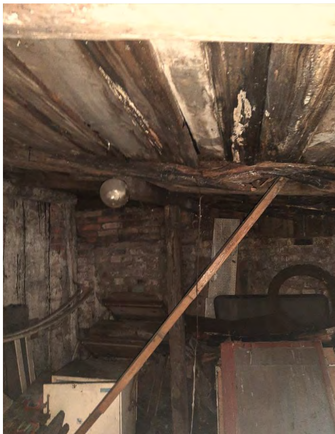
Fot. nr 39. Konstrukcja dachowa budynku gospodarczego – ślady zawilgocenia i zbutwienie deskowania oraz krokwi dachowej. Widoczne prowizoryczne podparcie
