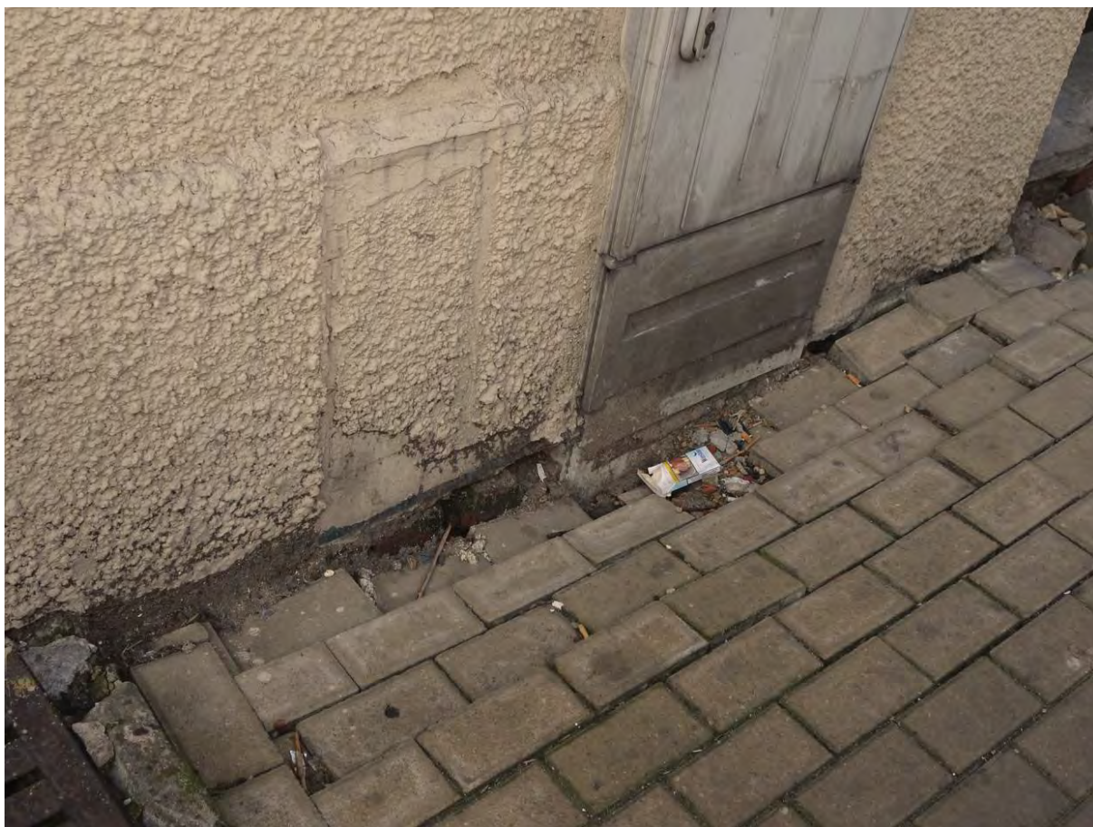
Fot. nr 20. Lokalne zapadlisko nawierzchni chodnikowej.
