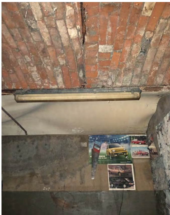
Fot. nr 37. Sklepienie stropu nad parterem budynku gospodarczego. Widoczna korozja prętów wzmacniających.
