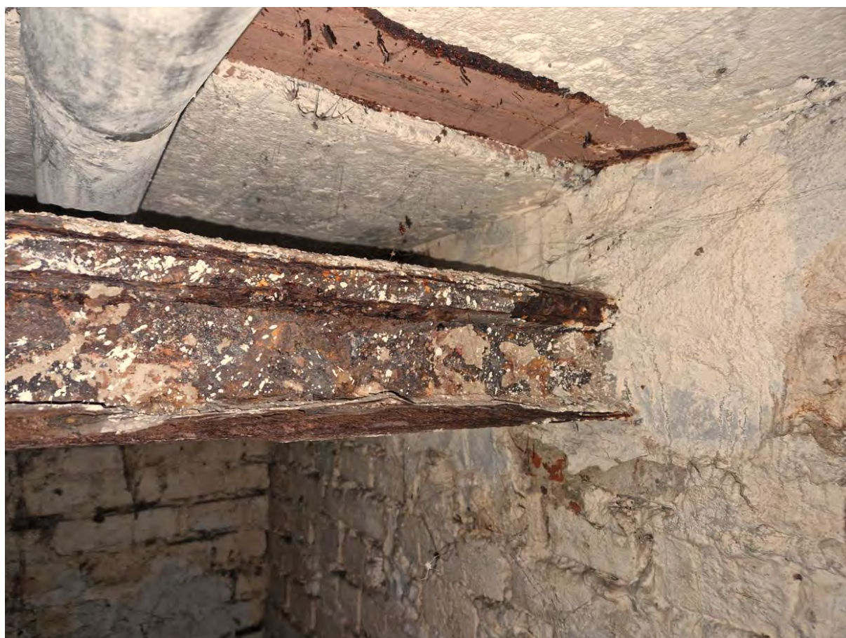
Fot. nr 31. Korozja belki stalowej – złuszczenie dolnej stopki belki.
