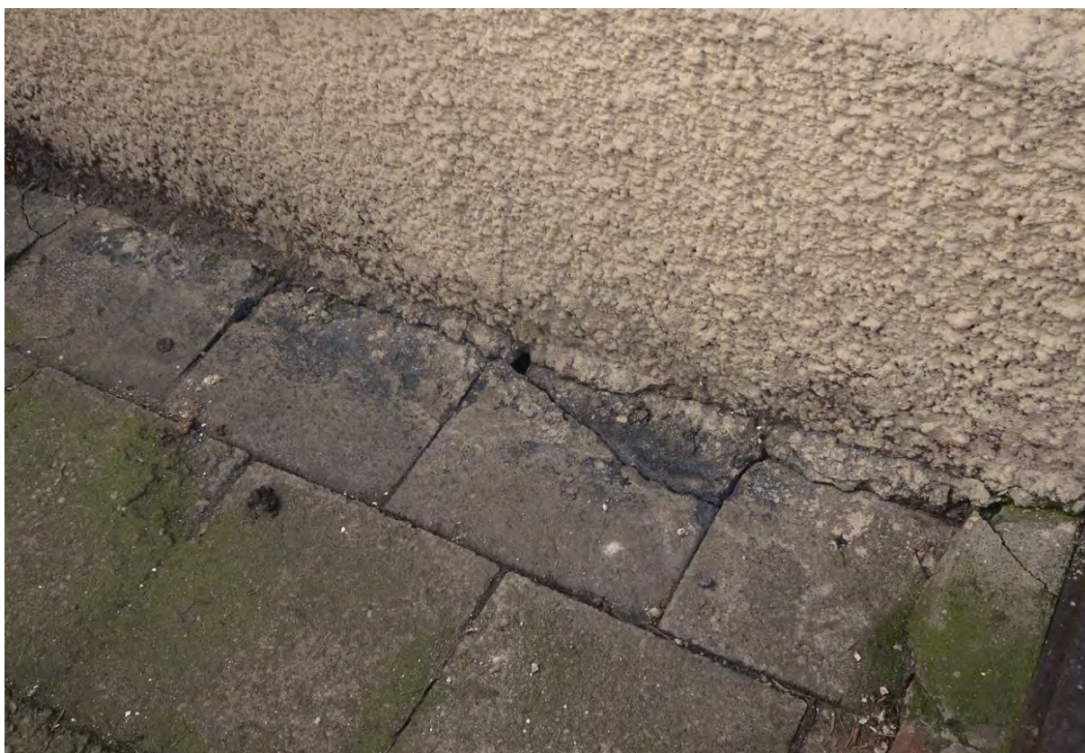
Fot. nr 19. Zawilgocenie ścian przyziemia, lokalne uszkodzenia płyt chodnikowych, nieszczelności na połączeniu nawierzchni ze ścianą.
