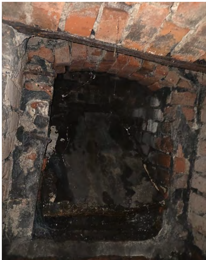
Fot. nr 32. Korozja belki stalowej w nadprożu okna piwnicznego.
