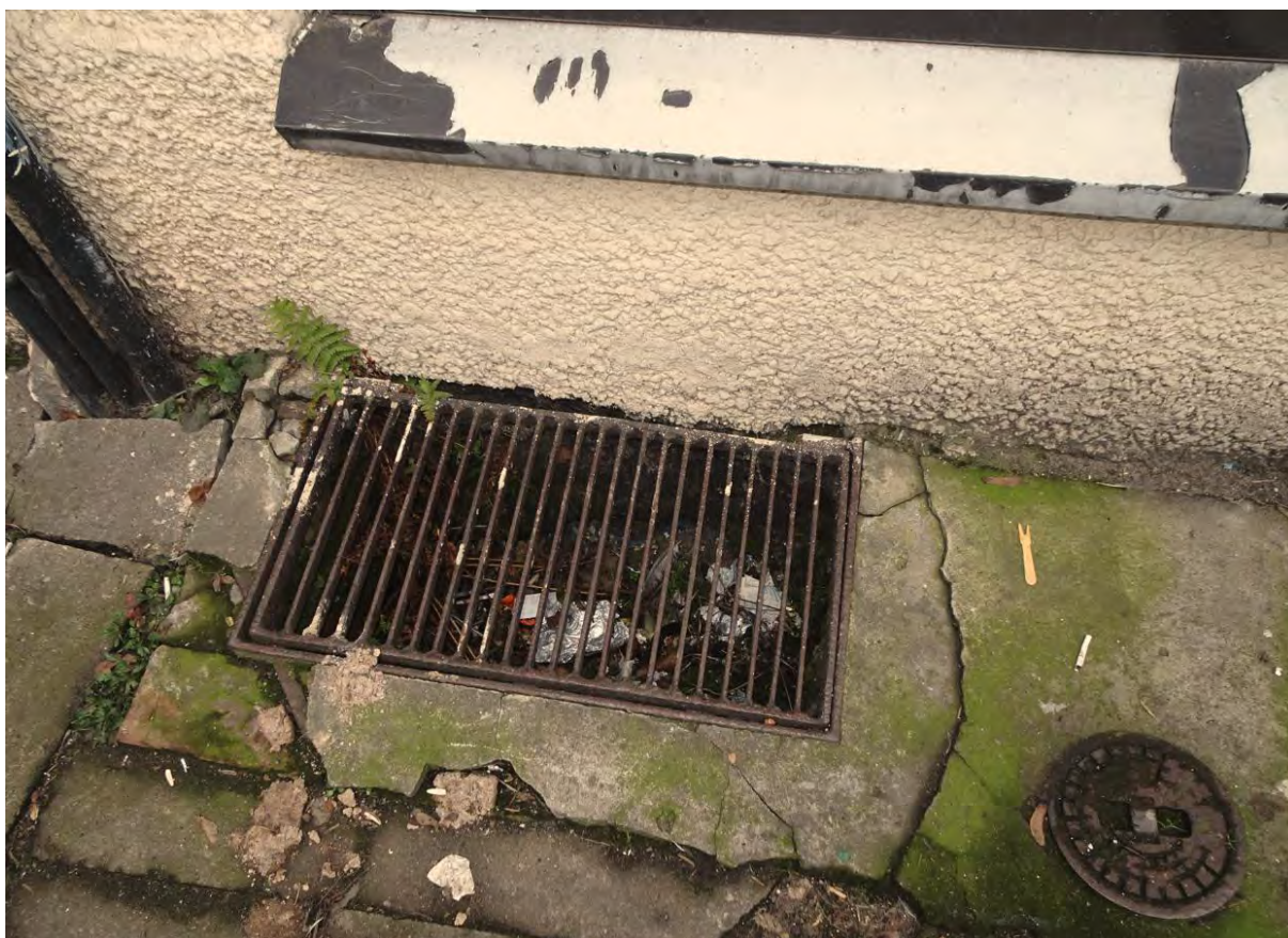
Fot. nr 17. Połączenie nawierzchni ze ścianą budynku, widoczne zanieczyszczenie naświetla okienka piwniczego.
