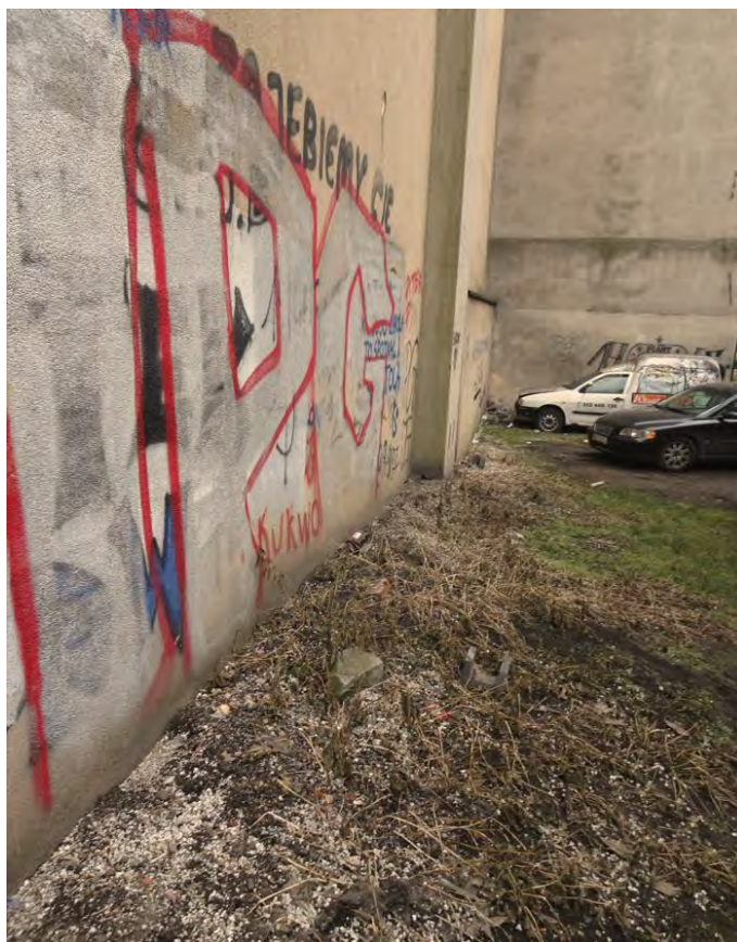
Fot. nr 22. Fragment elewacji północno – zachodniej budynku frontowego – zakończenia ocieplenia przy gruncie, brak opaski wzdłuż ściany zewnętrznej.
