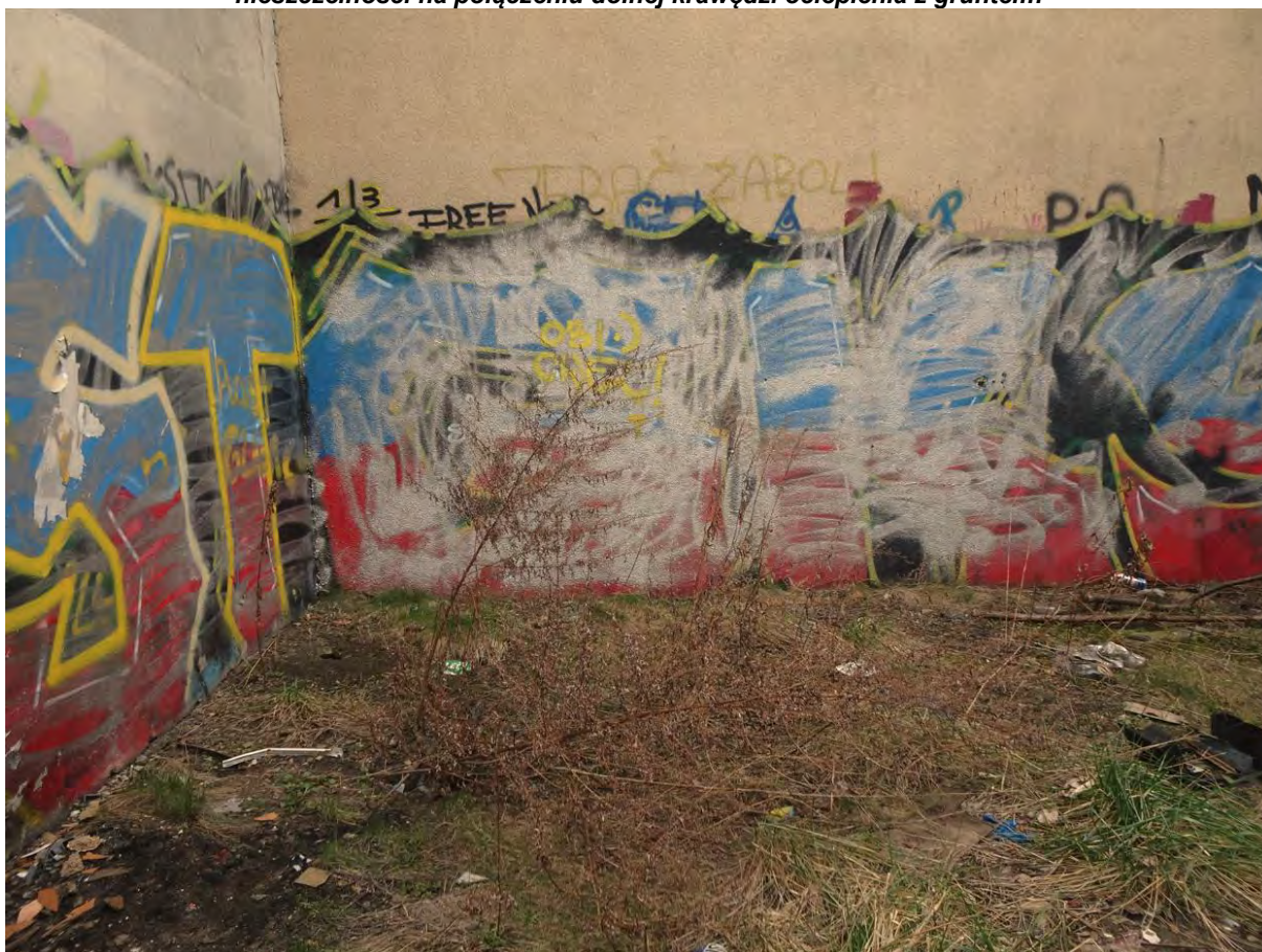
Fot. nr 25. Fragment elewacji północno – zachodniej budynku oficyny – zakończenia ocieplenia przy gruncie, brak opaski wzdłuż ściany zewnętrznej.
