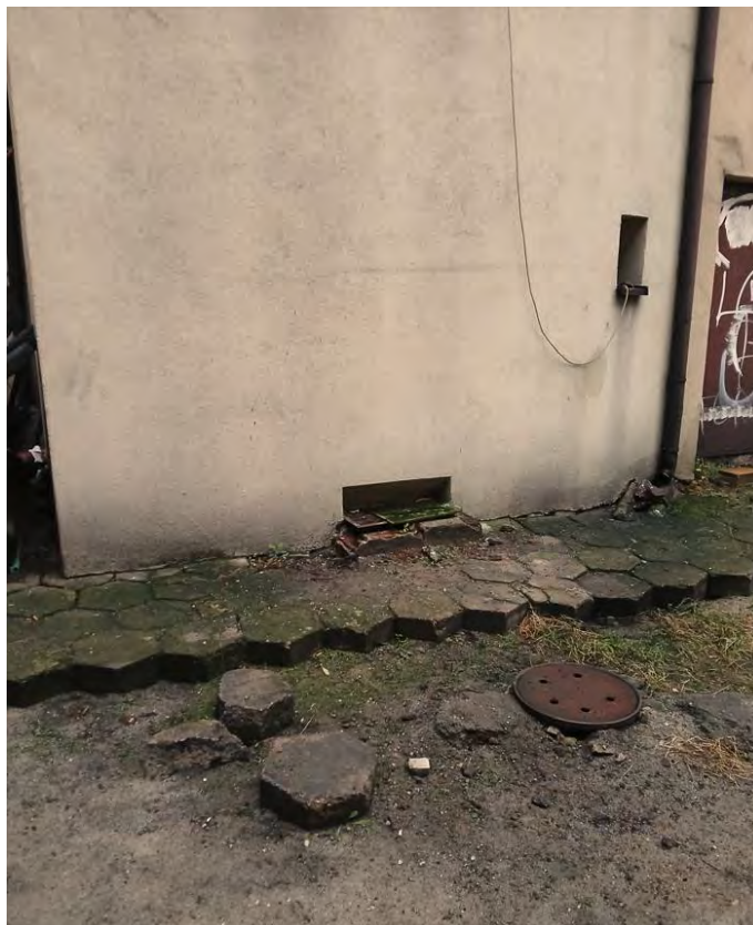
Fot. nr 26. Zakończenie ocieplenia ściany budynku frontowego od strony podwórza – widoczne ślady zawilgocenia dolnej części ocieplenia, brak uszczelnienia styku nawierzchni z ociepleniem.
