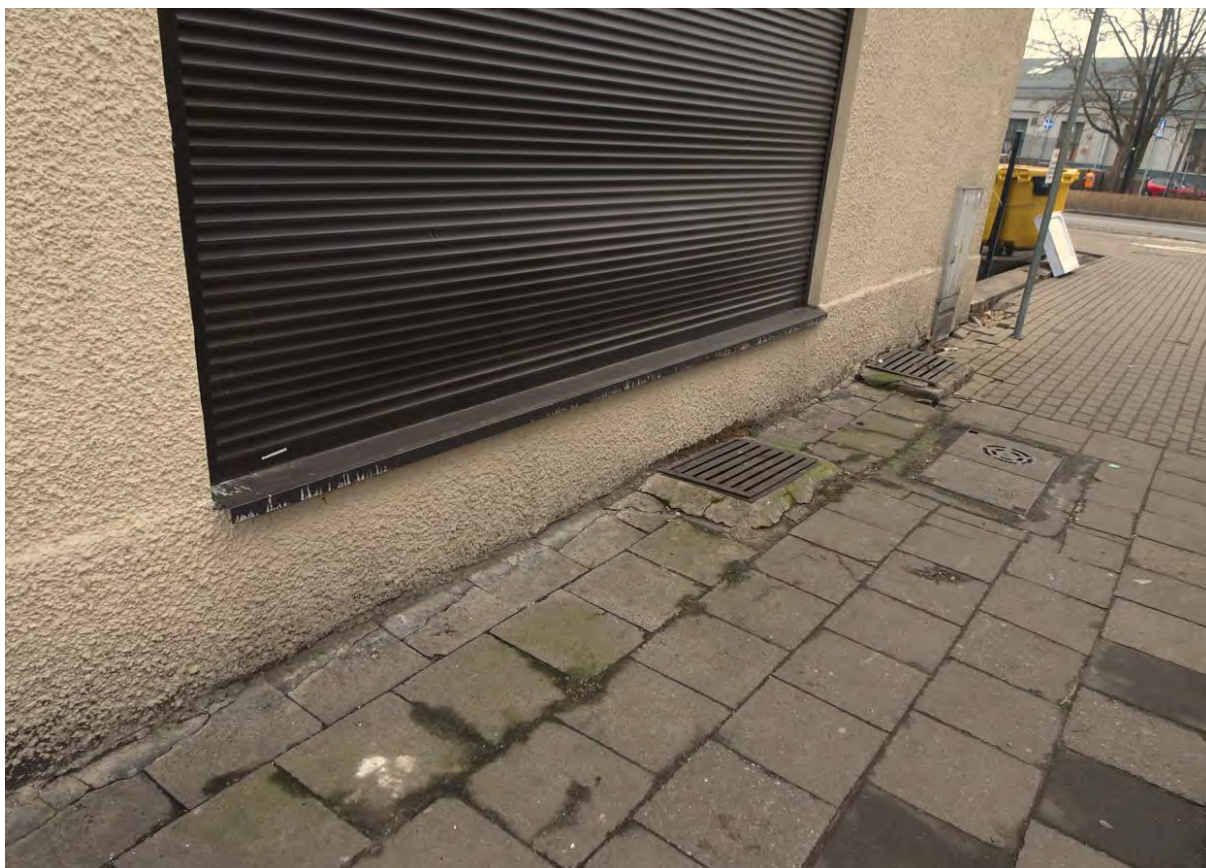
Fot. nr 18. Fragment przyziemia elewacji północno – wschodniej budynku frontowego – widoczne lokalne zawilgocenie ścian przy nawierzchni chodnika, lokalne uszkodzenia i zapadliska nawierzchni z płytek chodnikowych.
