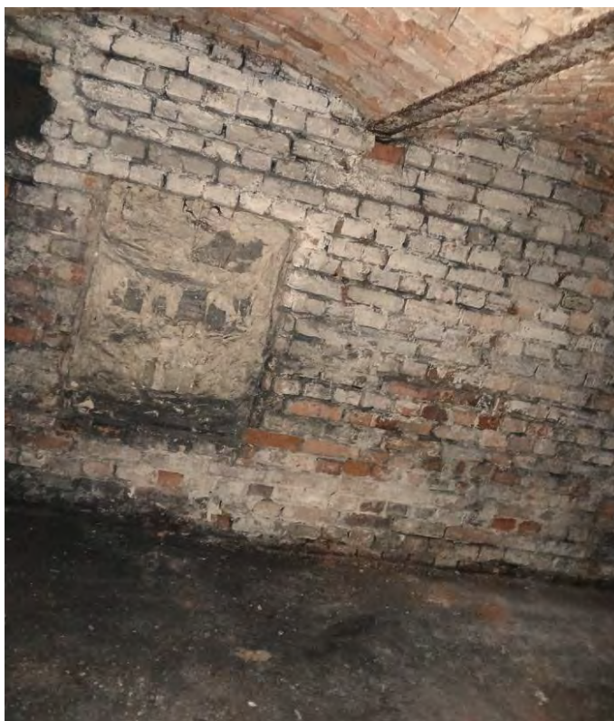
Fot. nr 28. Fragment pomieszczenia piwnicznego w budynku frontowym – widoczne zawilgocenia posadzki, lokalne złuszczenia cegieł i brak spoinowania murów, korozja spodu belki stropowej.
