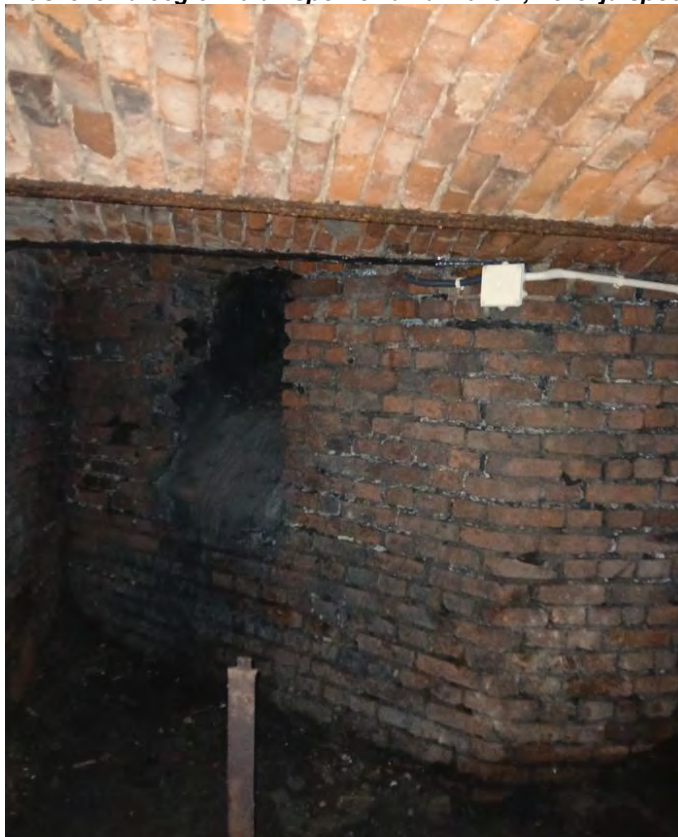
Fot. nr 29. Fragment pomieszczenia piwnicznego w budynku frontowym – widoczne zawilgocenia posadzki, lokalne złuszczenia cegieł i brak spoinowania murów, korozja spodu belki stropowej, ślady zamakania murów w obrębie okienka piwnicznego.
