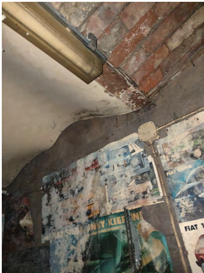
Fot. nr 38. Korozja belki stropowej stropu nad parterem.
