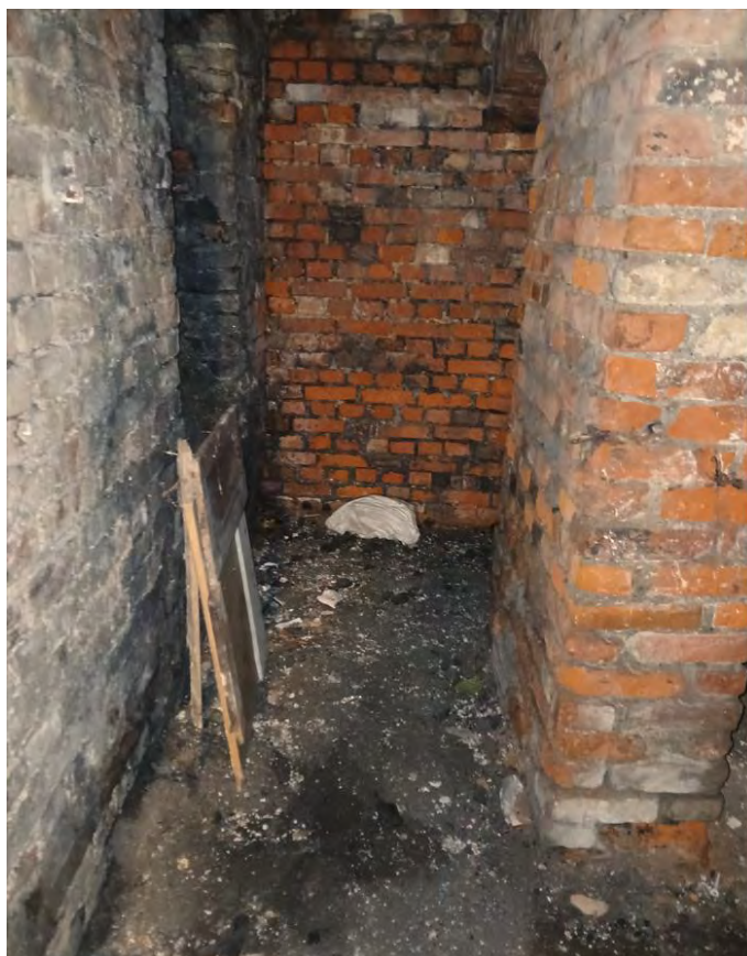
Fot. nr 33. Fragment pomieszczenia piwnicznego w budynku oficyny – widoczne zawilgocenia posadzki, lokalne złuszczenia cegieł i brak spoinowania murów.
