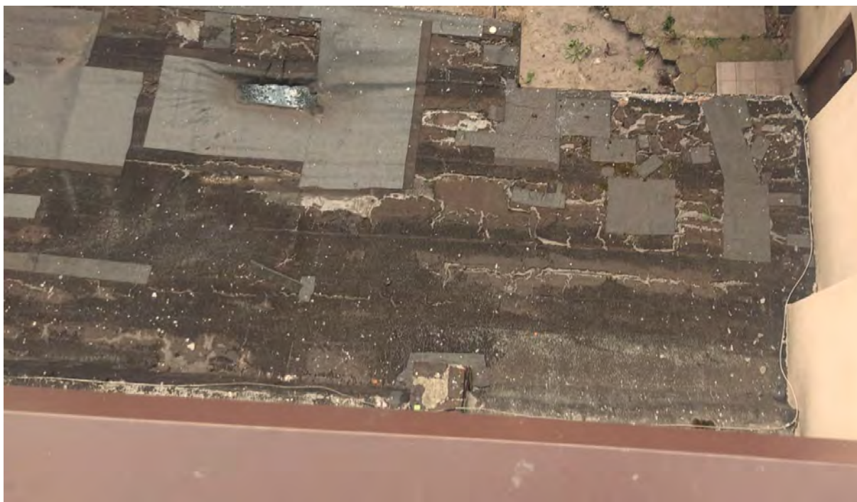
Fot. nr 42. Ogólny widok pokrycia dachowego budynku gospodarczego – widoczne uszkodzenia pokrycia oraz załamanie powierzchni dachu.
