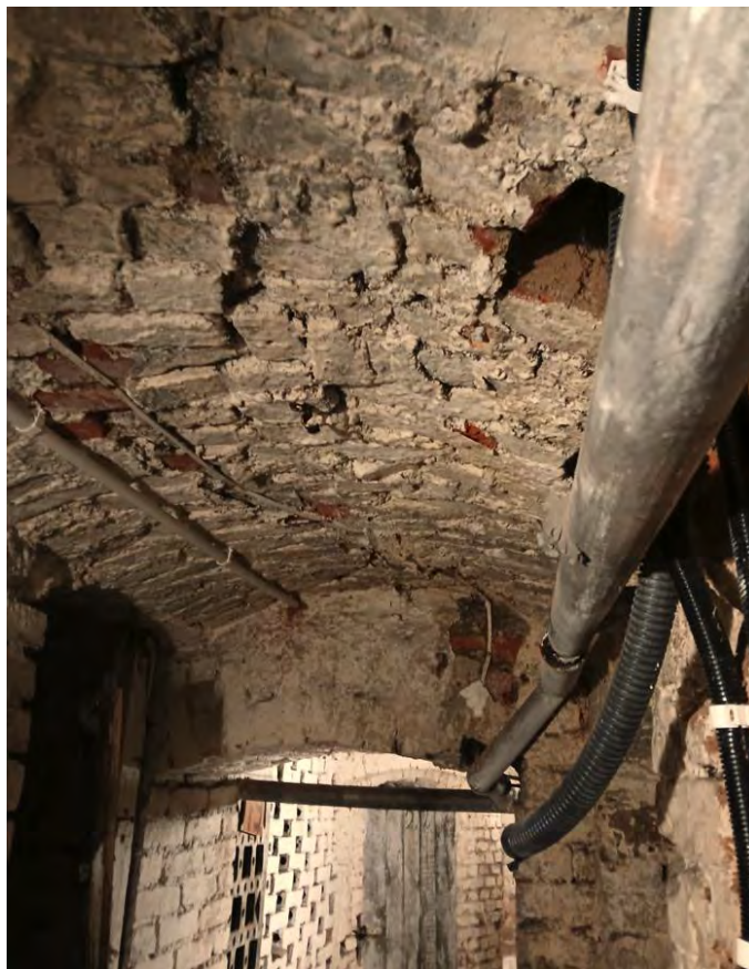
Fot. nr 36. Sklepienie odcinkowe korytarza – widoczne lokalne ubytki cegieł, ubytki spoinowania.
