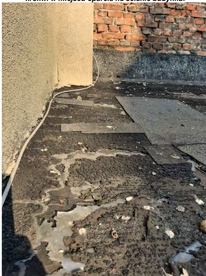
Fot. nr 41. Uszkodzone papowe pokrycie dachu.
