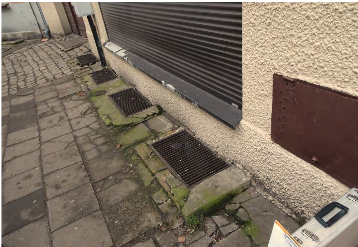
Fot. nr 16. Fragment przyziemia elewacji północno – wschodniej budynku frontowego – widoczne lokalne zawilgocenie ścian przy nawierzchni chodnika.
