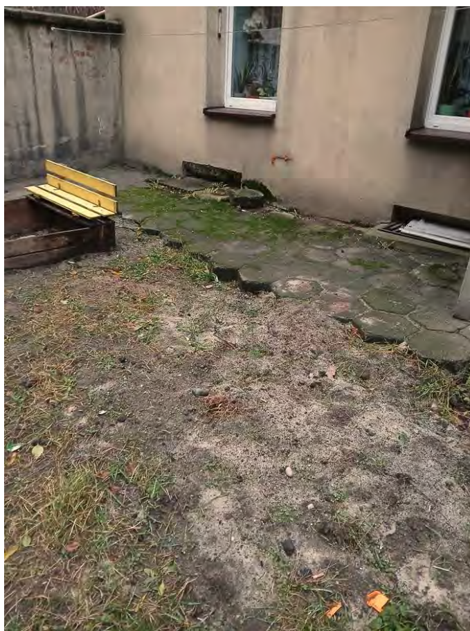
Fot. nr 27. Zakończenie ocieplenia ściany budynku oficyny od strony podwórza – widoczne ślady zawilgocenia dolnej części ocieplenia, brak uszczelnienia styku nawierzchni z ociepleniem.
