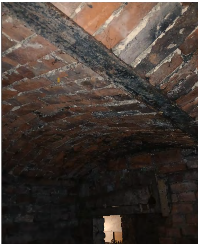
Fot. nr 34. Belka stropu odcinkowego – korozja spodu stopki belki.
