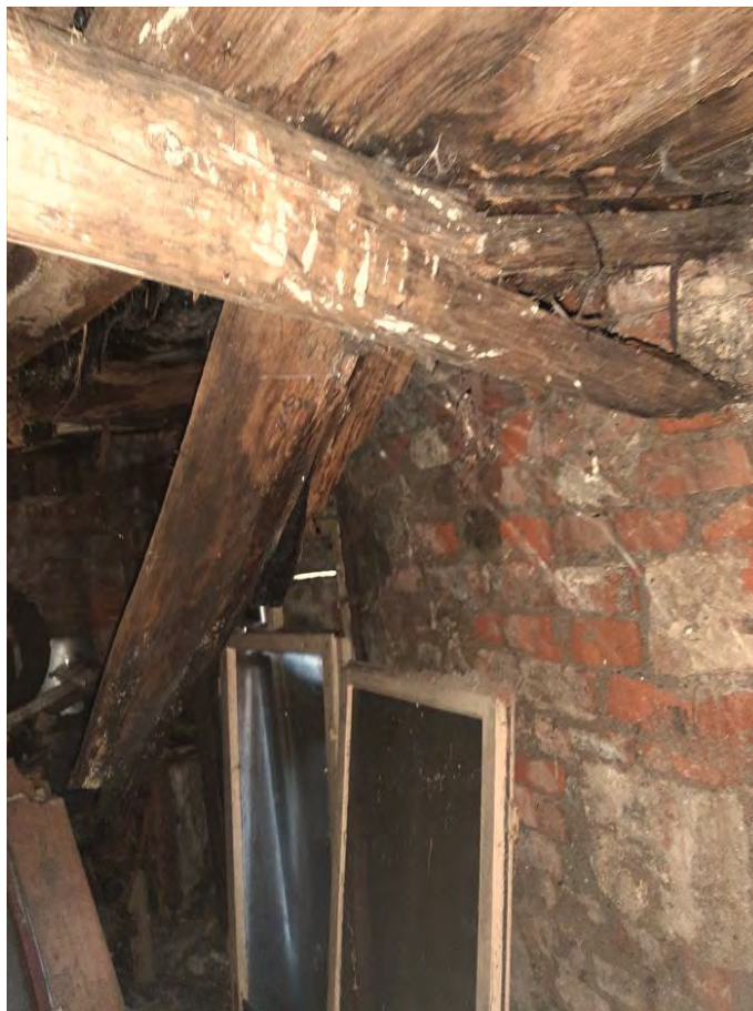
Fot. nr 40. Destrukcja konstrukcji dachu – połamane deski poszycia dachowego, zbutwienie i złamanie krokwi w miejscu oparcia na ścianie budynku.
