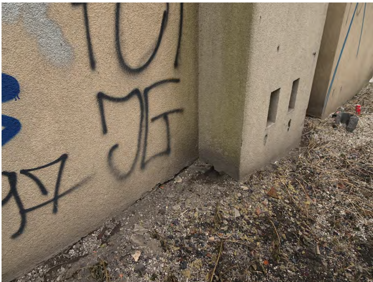
Fot. nr 24. Zakończenia ocieplenia przy gruncie, brak opaski wzdłuż ściany zewnętrznej, widoczne nieszczelności na połączeniu dolnej krawędzi ocieplenia z gruntem.
