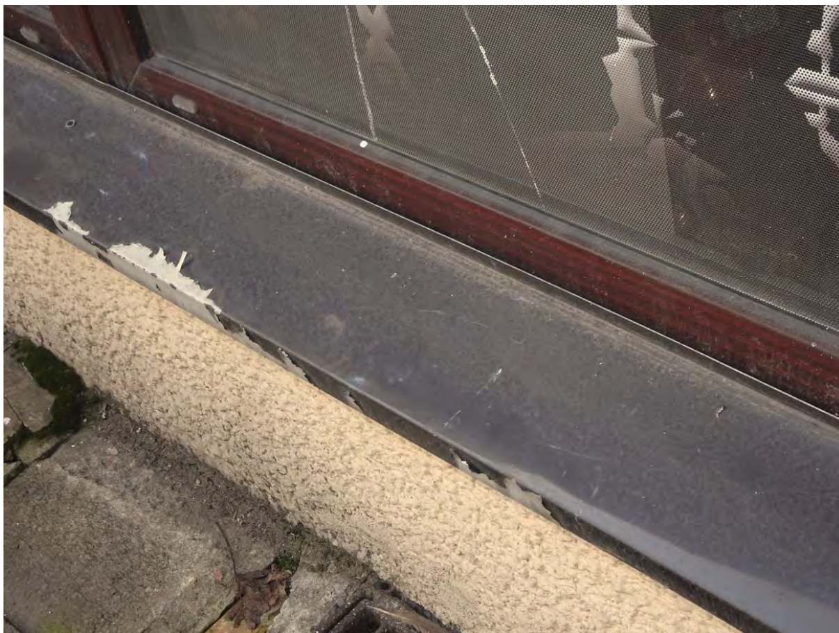
Fot. nr 21. Nieprawidłowe osadzenie parapetów witryny – nieszczelności między blachą a ramą witryny, obróbka nie wprowadzona pod ramę okienną.
