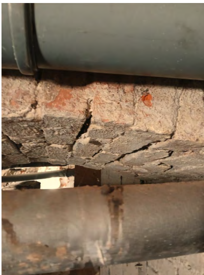
Fot. nr 35. Ceglane nadproże korytarza – widoczne ubytki spoinowania cegieł.
